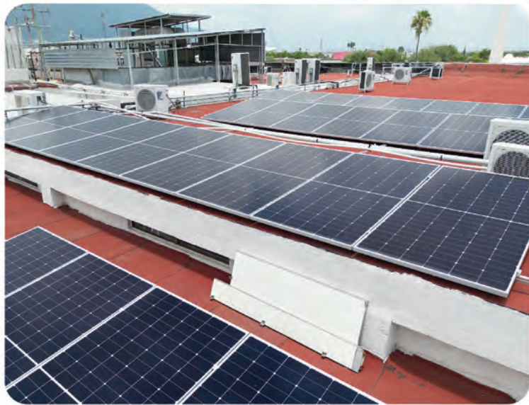
Impulsamos edificios verdes, instalando paneles solares en el edificio de la Presidencia Municipal y sus estacionamientos.
